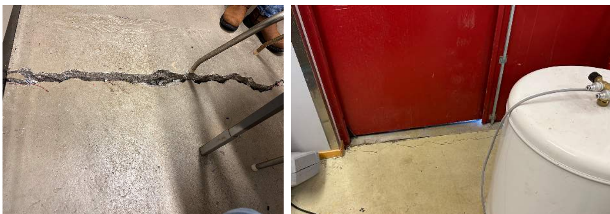
Figur 4-1: Bilde av sprekk i gulv tavlerom og sprekkdannelse ut mot portåpninger fra leger
